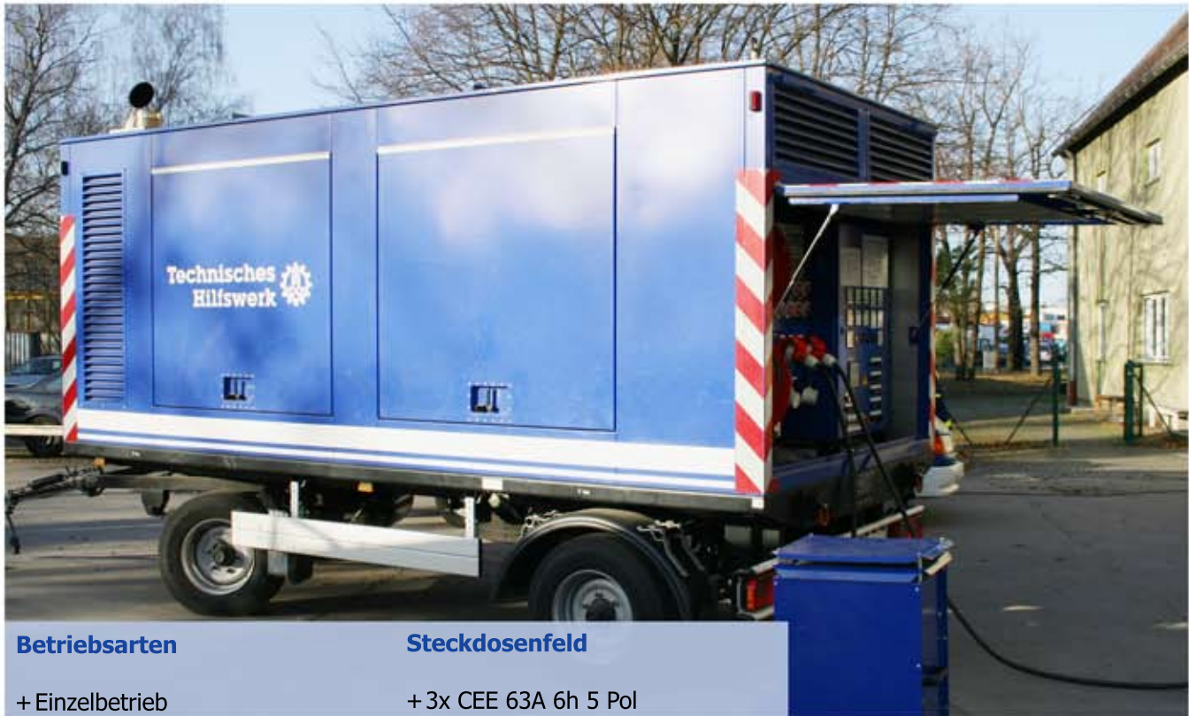
Mobile Netzersatzanlage der Fachgruppe Elektroversorgung des OV München Mitte.
